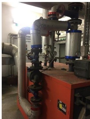
Figura 4.11 - Particolare della caldaia
