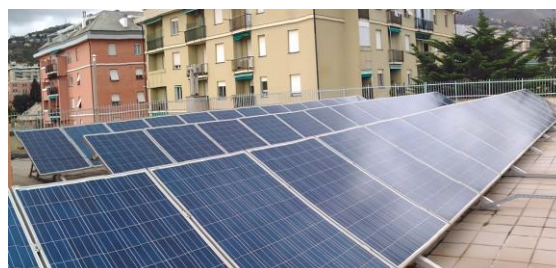
Figura 4.15 - Vista dell'impianto fotovoltaico
