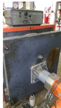
Figura 4.12 - Particolare della caldaia
