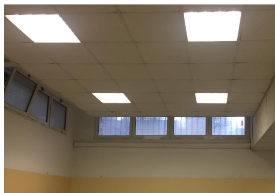
Figura 4.14 - Particolare dei corpi illuminanti ubicati nella zona termica n°1
